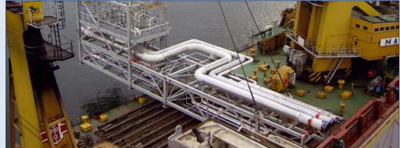
Estakady rurociągowe, projekt Omen Lange, Morze Norweskie
